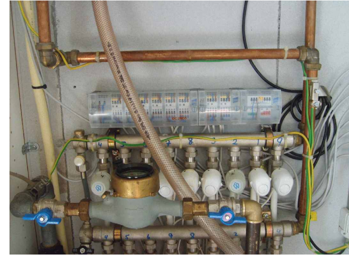
Automatik med pumpe-stop-relæ, der styrer gaskedel er nu monteret.
